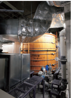
駐車場の奥の機械室内には檜製の受水槽が設置されています。
